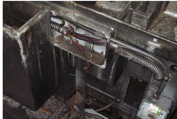
Bild 4: angeschmorte freiliegende Kabel
