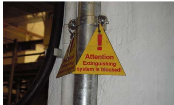
Bild 3: Blockieren der Löschanlage
